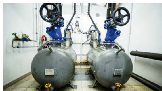
Abb. 3: Das pneumatische Pumpwerk, Innenansicht mit Blick auf zwei Arbeitsbehälter
