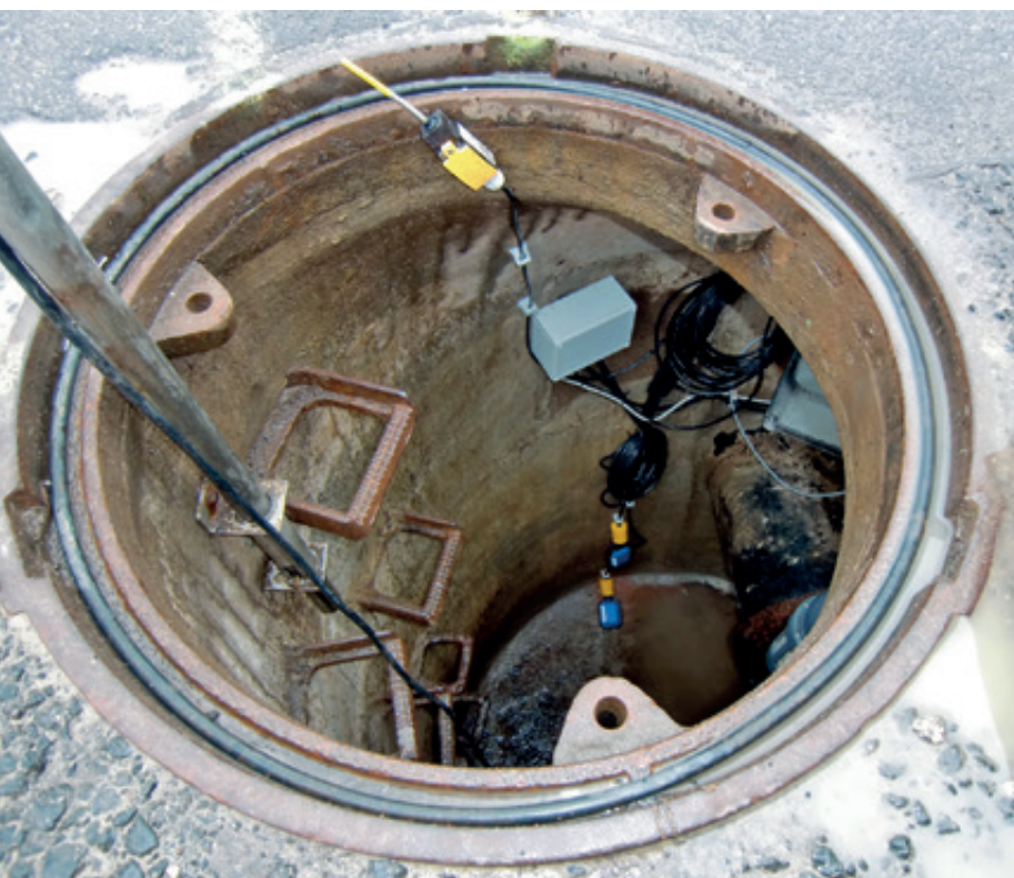
Abb. 1: Moderne Technik in der Tiefe: BEV-Schacht mit Zutrittskontrolle und Havariealarm
