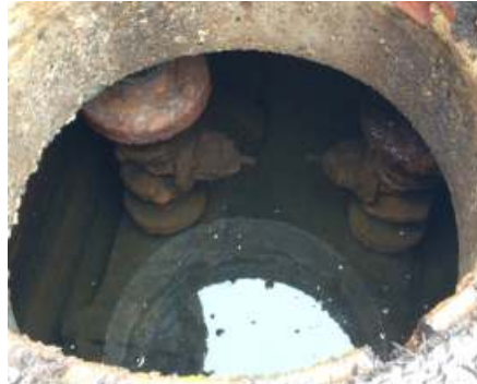
Havariertes Schacht mit zwei Be- und Entlüftungsventilen
