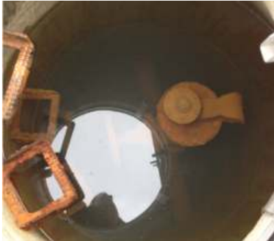
Überflutetes Be- und Entlüftungsventil
